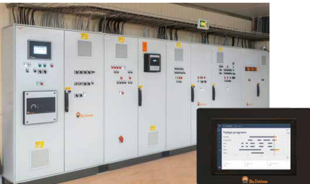
Painel de controle: boa estrutura, operação simples, alto grau de proteção, aparência clean
