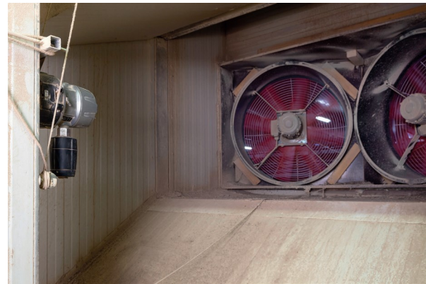
Medição da concentração de NH 3 no ar de exaustão.
