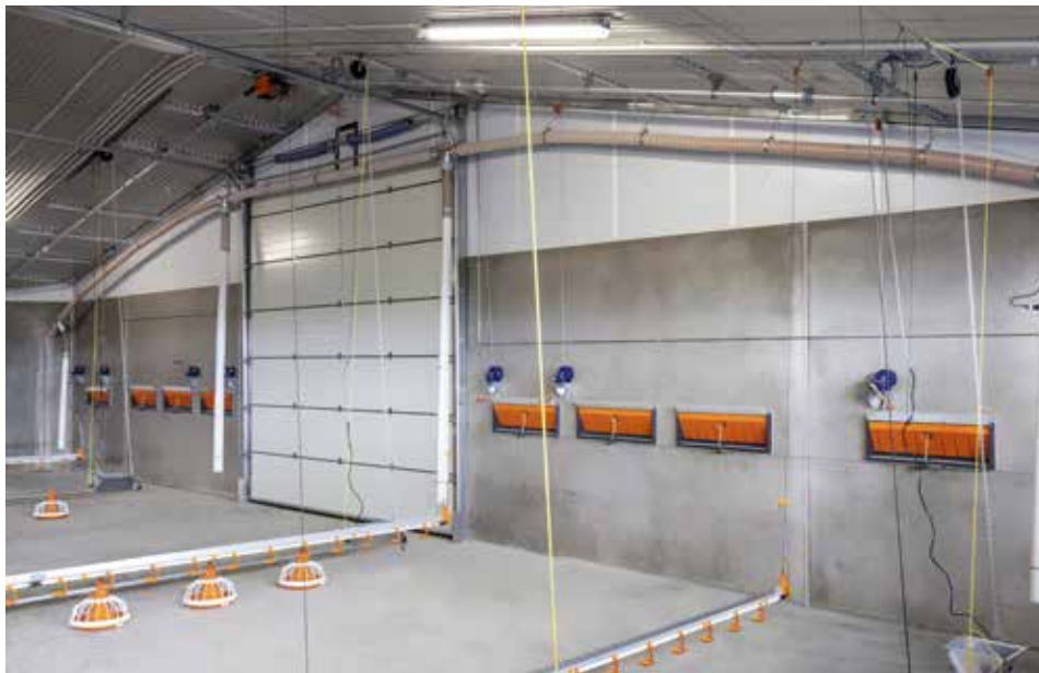
Aplicação do FlexVey PUR em um galpão de frango de corte – simples instalação
