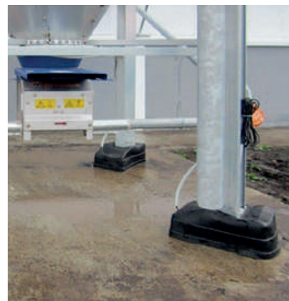
Proteção para os pés do silo para pesagem em clima extremo.
